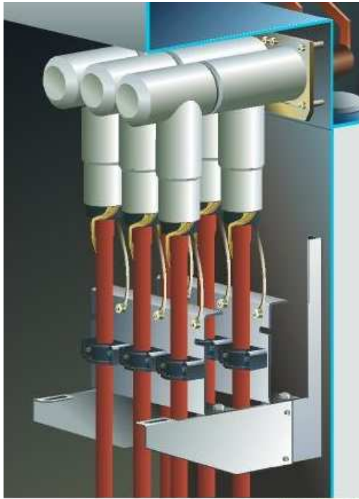
2 câbles par phase
